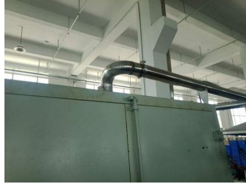
烘干收集管道
