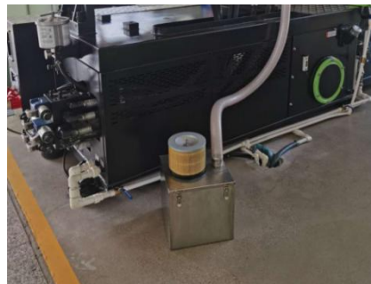
注塑机自带除尘设备
