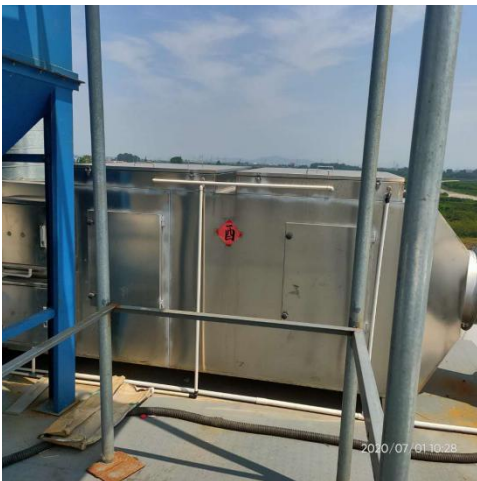
废气处理设备
