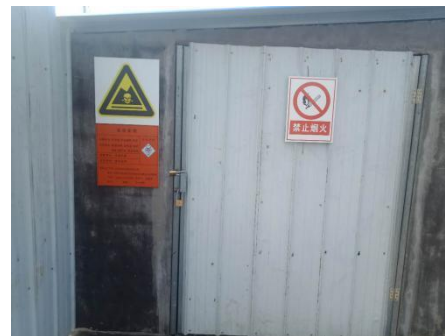
危险废物暂存间
